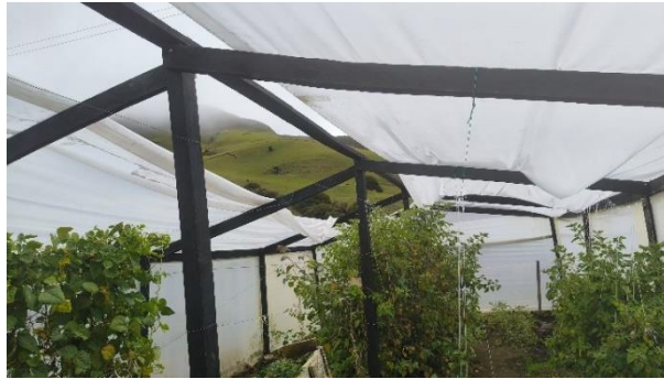
Invernadero Reserva Tatascos. Cubierta afectada por fuertes vientos.
